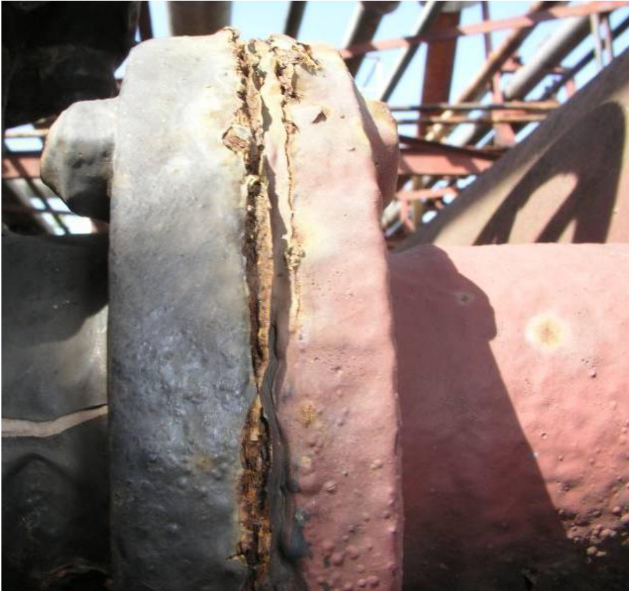
Abbildung 8 Kokerei Zollverein, Rohrleitungstrasse „m“, mit Asbest abgedichtete Flanschverbindung (Foto: Kornelius Götz).
