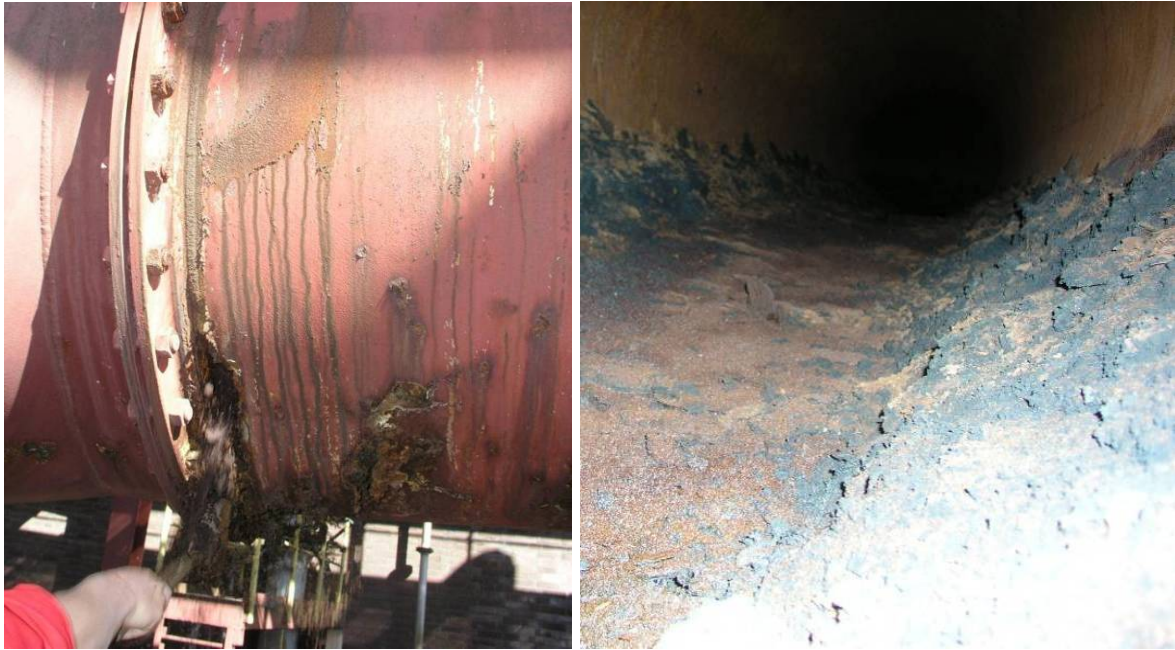
Abbildung 10 Kokerei Zollverein, Rohrleitungstrasse „18.14“, ein Beispiel für die Frage Rückbau, Reparatur oder Rekonstruktion? Links die bis auf „Wandstärke 0“ zerstörte Rohrleitungswand, rechts die Innenansicht mit Altlastenablagerung (Foto: Kornelius Götz).
