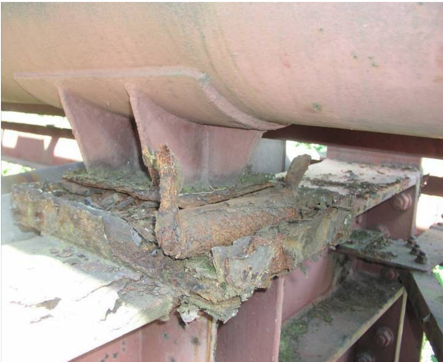
Abbildung 5 Kokerei Zollverein, Rohrleitungstrasse „m“, Korrosion von Tragwerk und Auflager (Foto: Kornelius Götz).
