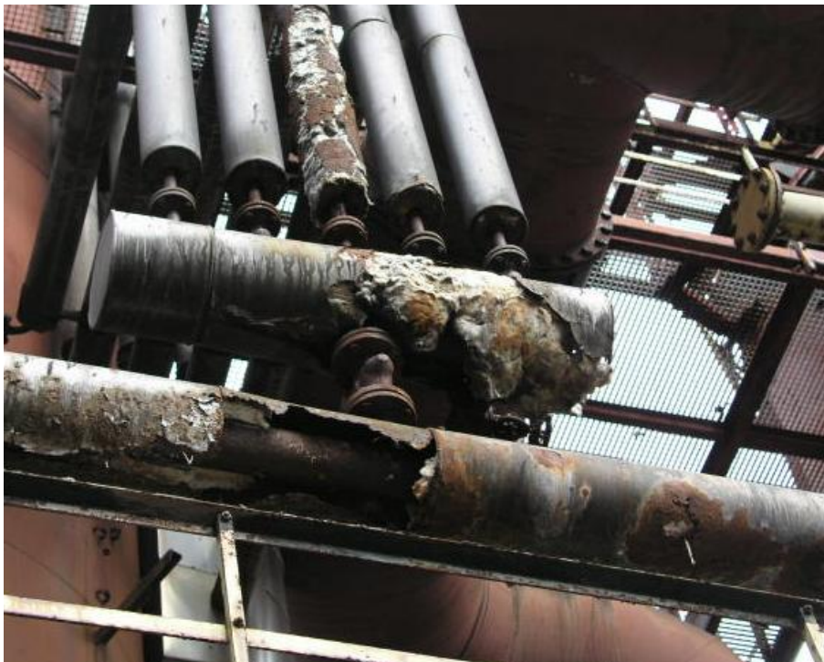
Abbildung 7 Kokerei Zollverein, Rohrleitungstrasse „m“, wärmeisolierte Rohre mit Zinkblechmantel und künstlichen Mineralfasern (KMF), ein drastisches Beispiel für die Kombination von Material- und Strukturvielfalt, Schadstoffbelastung und geringe Haltbarkeit (Foto: Kornelius Götz).
