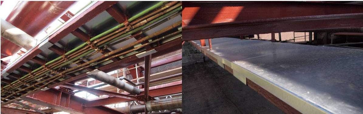
Abbildung 13 Kokerei Zollverein, Rohrleitungstrasse „m“, das Schutzdach auf der Kabeltrasse ermöglicht das Restaurierungsziel „Stillstand (Ruine)“, links Ansicht von unten, rechts von oben (Foto: Kornelius Götz).
