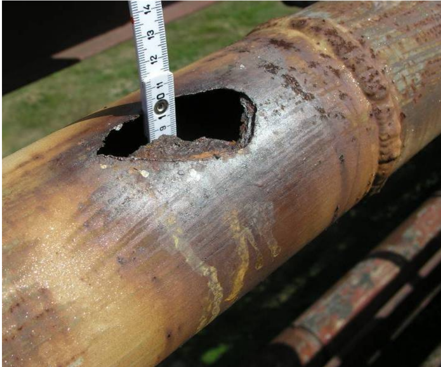
Abbildung 6 Kokerei Zollverein, Rohrleitungstrasse „m“, Innenkorrosion von Rohrleitungen durch nicht entleerte Produktionsrückstände (Foto: Kornelius Götz).
