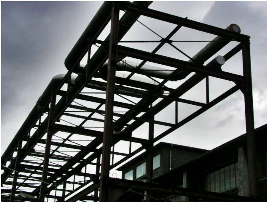
Abbildung 9 Kokerei Zollverein, Rohrleitungstrasse „18“, ein Beispiel für das Restaurierungsziel „Entkernen“ (Foto: Kornelius Götz).
