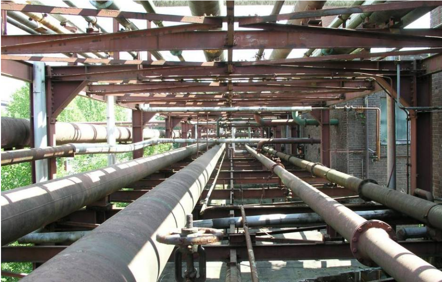
Abbildung 4 Kokerei Zollverein, Rohrleitungstrasse „m“, historisch gewachsene Belegung mit unterschiedlichsten Rohren (Foto: Kornelius Götz).
