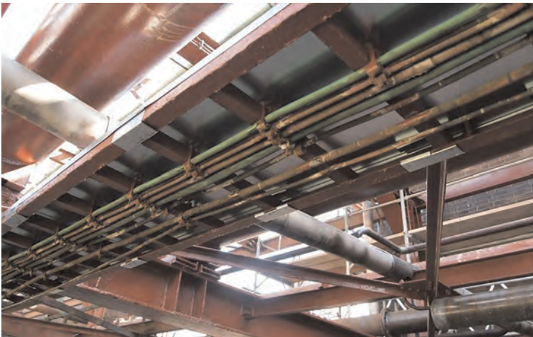
Abb. 10: Rohrtrasse „m“, besonders empfindliche Kleinteile wie Elektrokabel wurden unter einem Schutzdachsystem aus Zinkblech dauerhaft gesichert
